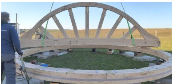
Die Fugbalken wurden als komplette Baueinheit mit eingesetzten Stichbalken und Kappring angeliefert.
