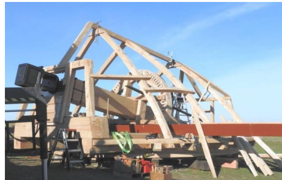
Die Form der Kappe ist nun schon gut zu erkennen. Die beiden Schwertbalken (braun) wurden aus Metall angefertigt. Daran wird später das Krühwerk zum Drehen der Kappe befestigt.
