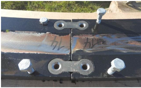
Detailaufnahme: Mit diesen speziellen Verbindungselementen wurden die Laufbahnschienen verbunden. In der Mitte ist die kehlförmige Laufbahn zu sehen.
